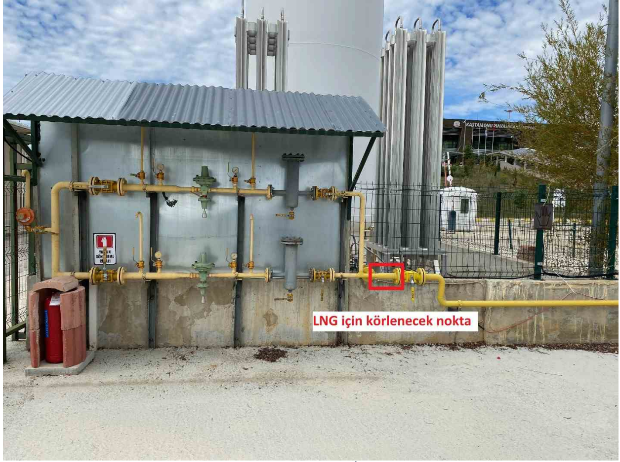
Şekil 4 Düşürücü Tesisat ve LNG İçin Körlenecek Nokta
